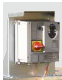
La sonda di pressione invia l'informazione al variatore di frequenza che modifica la velocità del ventilatore
