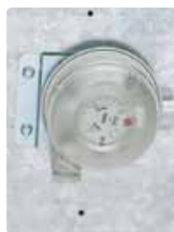
Pressostato montato a bordo. Bocche di aspirazione ed espulsione con guarnizione a tenuta
