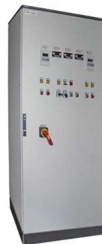
Quadro elettrico ad armadio
