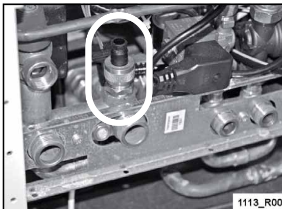
VISTA DAL BASSO DELLA CALDAIA
