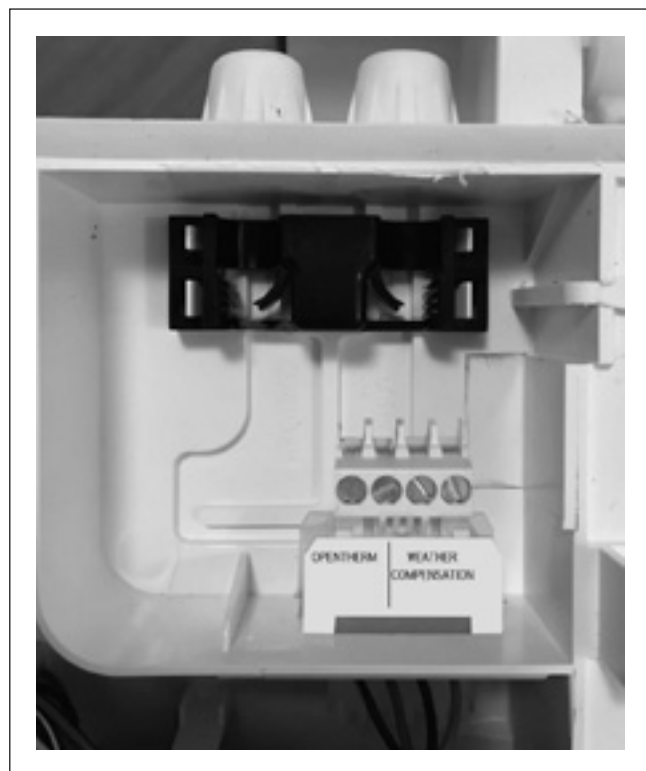
Collegamenti installatore. (Lato destro)
