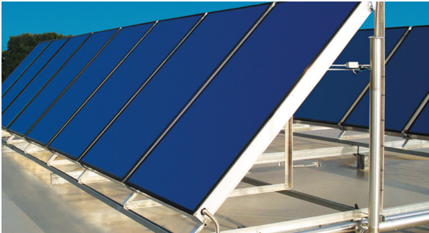
Impianto a tetto piano con 16 collettori
