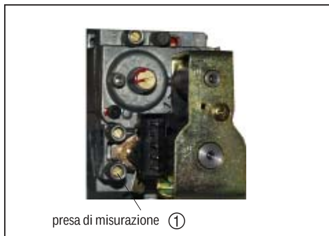
Figura: controllo pressione di allacciamento gas
