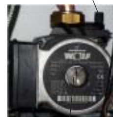
vite di sfiato pompa circuito riscaldamento
