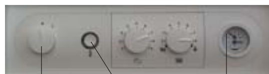
Interruttore generale Tasto di ripristino Manometro
