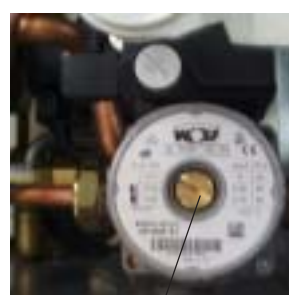
vite di sfiato pompa carica bollitore
