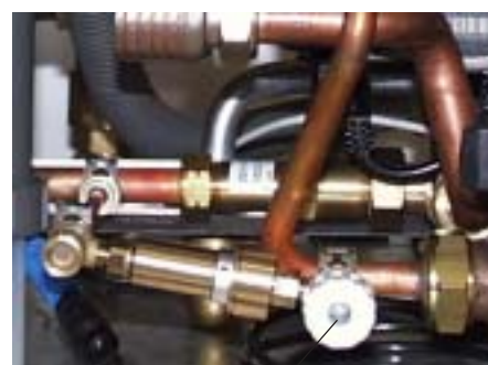
rubinetto di carico (incorporato in caldaia)
