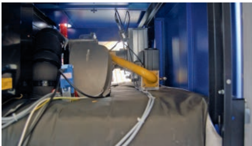
Particolare sportello pulizia bruciatore
