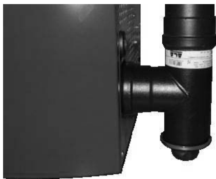
Fig. 63 - Pulizia canale da fumo
